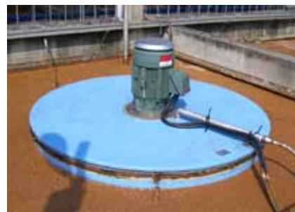
Un OxyMix installé dans un bassin de traitement d'eaux usées
